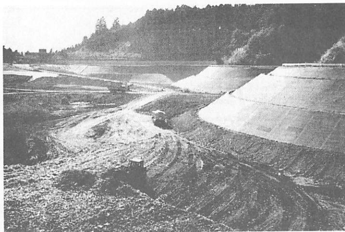
右側の堤防のように見えているのが、ごみ汁漏れを防ぐゴムシートだ。ごみで埋まった底部も全体にシートが敷き詰められてある。10月13日、東京都日の出町の谷戸沢廃棄物広域処分場で
