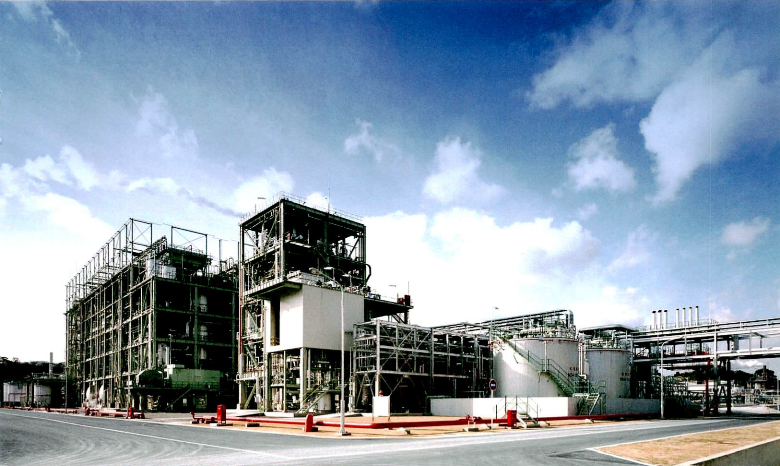
MDI製造設備
