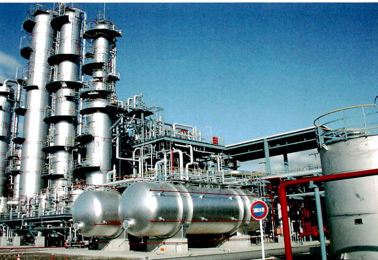
塩ビモノマー(VCM)製造設備
