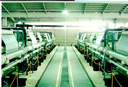
一酸化炭素製造設備
